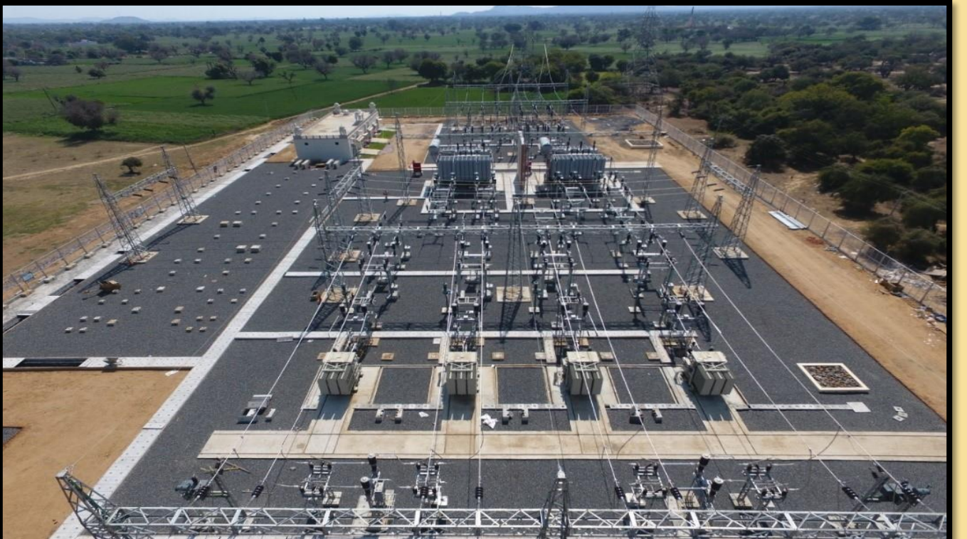
अटेली में ट्रेक्शन सब - स्टेशन
